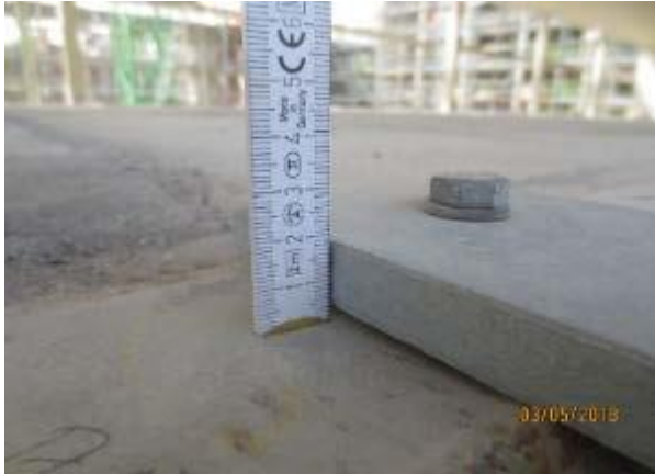
Abbildung 95: Baustelle BO - Mängelbeseitigung verdrehter Stahlverbundträger, [ACMS Architekten GmbH], 03.05.2018
