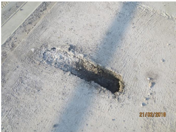
Abbildung 61: Baustelle BO - schwindender Betonverguss an der Öffnung für die Bewehrung, [ACMS Architekten GmbH], 21.02.2018
