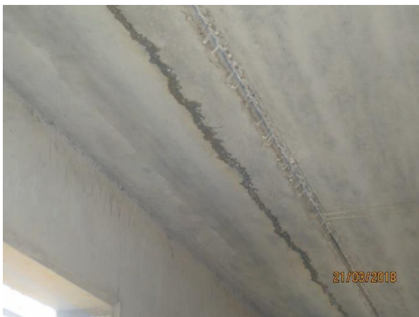
Abbildung 48: Baustelle BO - Frostschaden (Rissbildung an Hohlplattenunterseite) durch nicht ausgeführte Entwässerungslöcher, [ACMS Architekten GmbH], 21.03.2018
