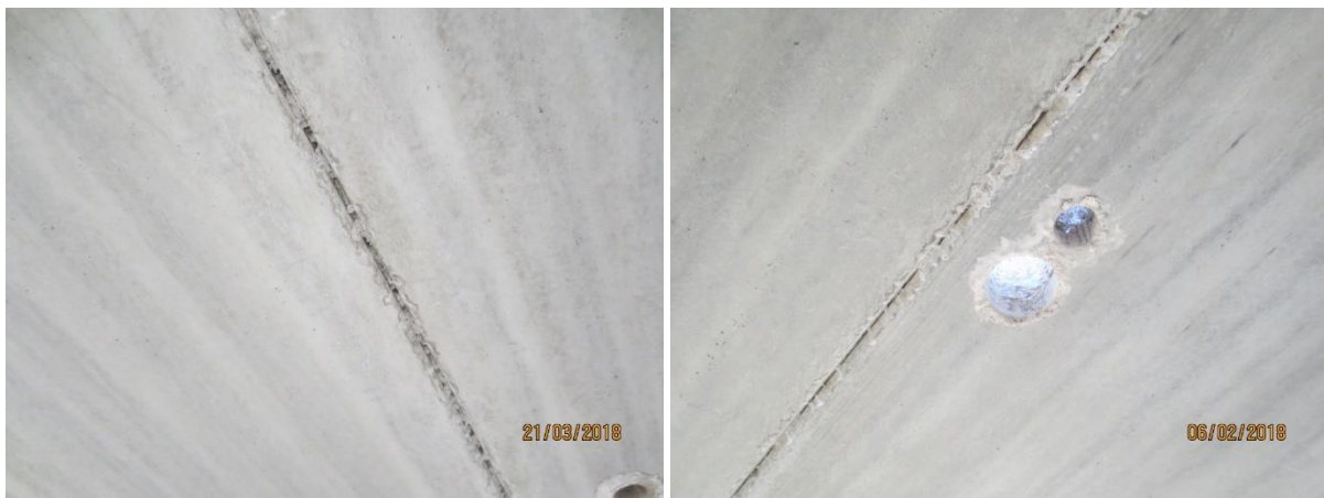
Abbildung 49: Baustelle BO - schlechtes Beispiel einer zu breiten Fuge, [ACMS Architekten GmbH], 21.03.2018
