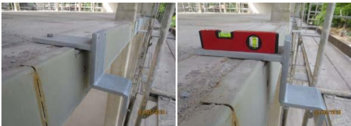
Abbildung 93: Baustelle BO - Mängelbeseitigung verdrehter Stahlverbundträger, [ACMS Architekten GmbH], 03.05.2018
