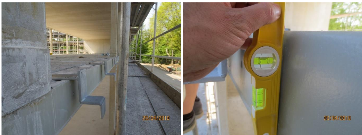
Abbildung 90: Baustelle BO - verdrehter Stahlverbundträger, [ACMS Architekten GmbH], 20.04.2018
