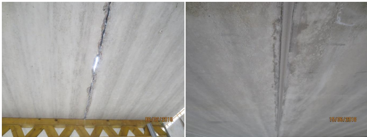
Abbildung 51: Baustelle BO - Plattenfuge mit stellenweise abgeplatzten Fugenkanten, [ACMS Architekten GmbH], 06.02.2018
