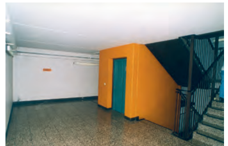
(3) In das innenliegende Treppenhaus fiel fast kein Tageslicht.
