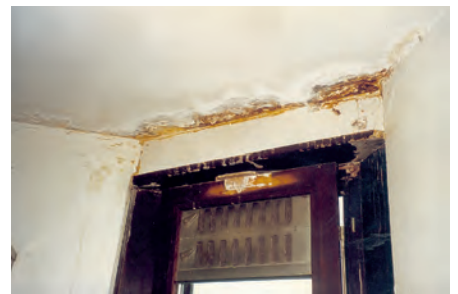
(4) Die Fassaden waren aufgrund konstruktiver Mängel undicht.
